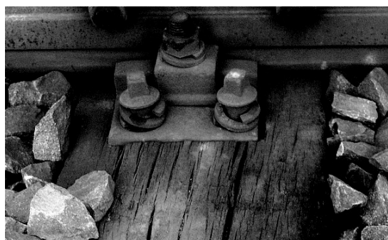
Fig. 5. Increased sleeper wear as a result of frequent handling during the rail geometrical position repair Rys. 5. Zwiększone zużycie podkładu kolejowego w wyniku częstych zmian położenia geometrycznego szyny
