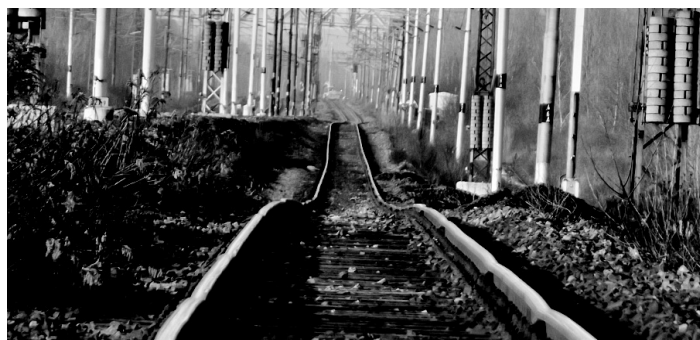
Fig. 4. Defects in rail alignment Rys. 4. Uszkodzenia torów
