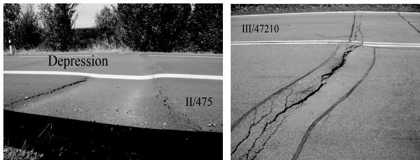
Fig. 3. Road defects Rys. 3. Uszkodzenia dróg
