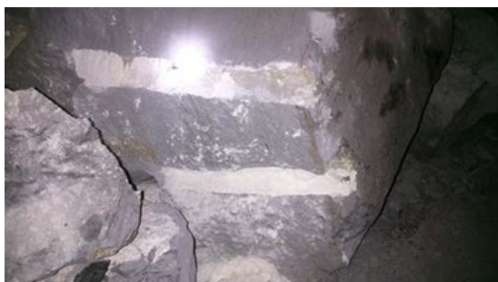
Rys. 3. Rozsadzona obudowa betonowa
